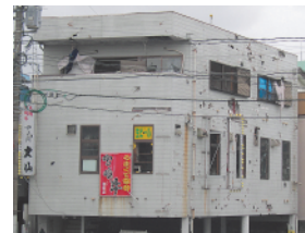
竜巻による飛来物により被害を受けた建物の調査
